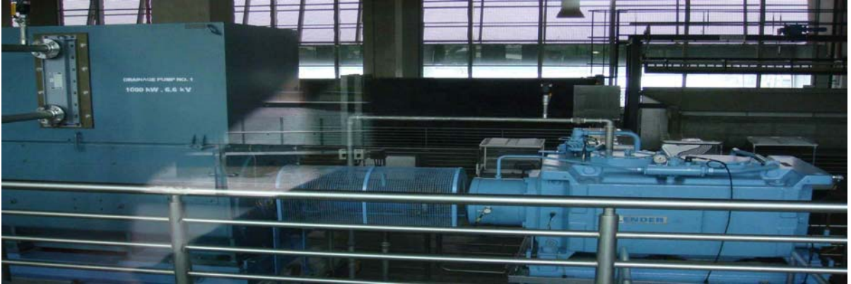
<그림 4> 1.6MW 대용량 펌프 시설
